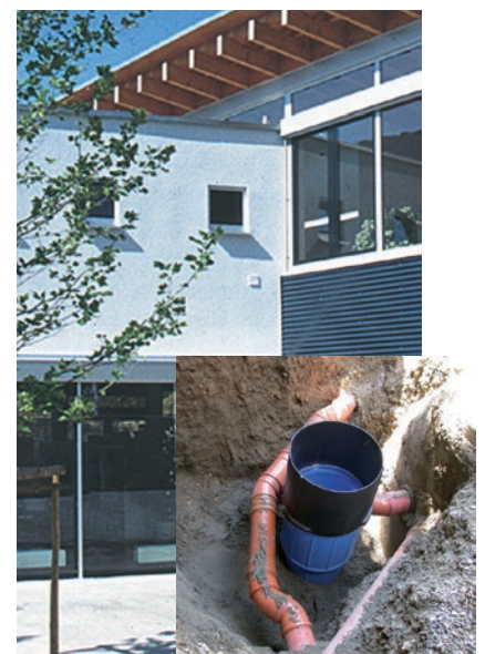
Filtrering av takavvattning.
